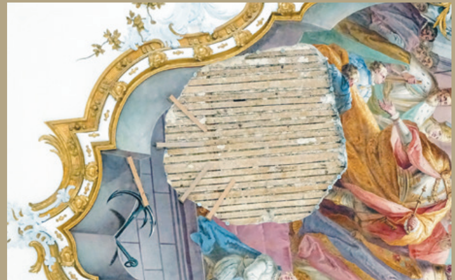
Absturzstelle 2016 ca. 2,6 m 2 (2)
