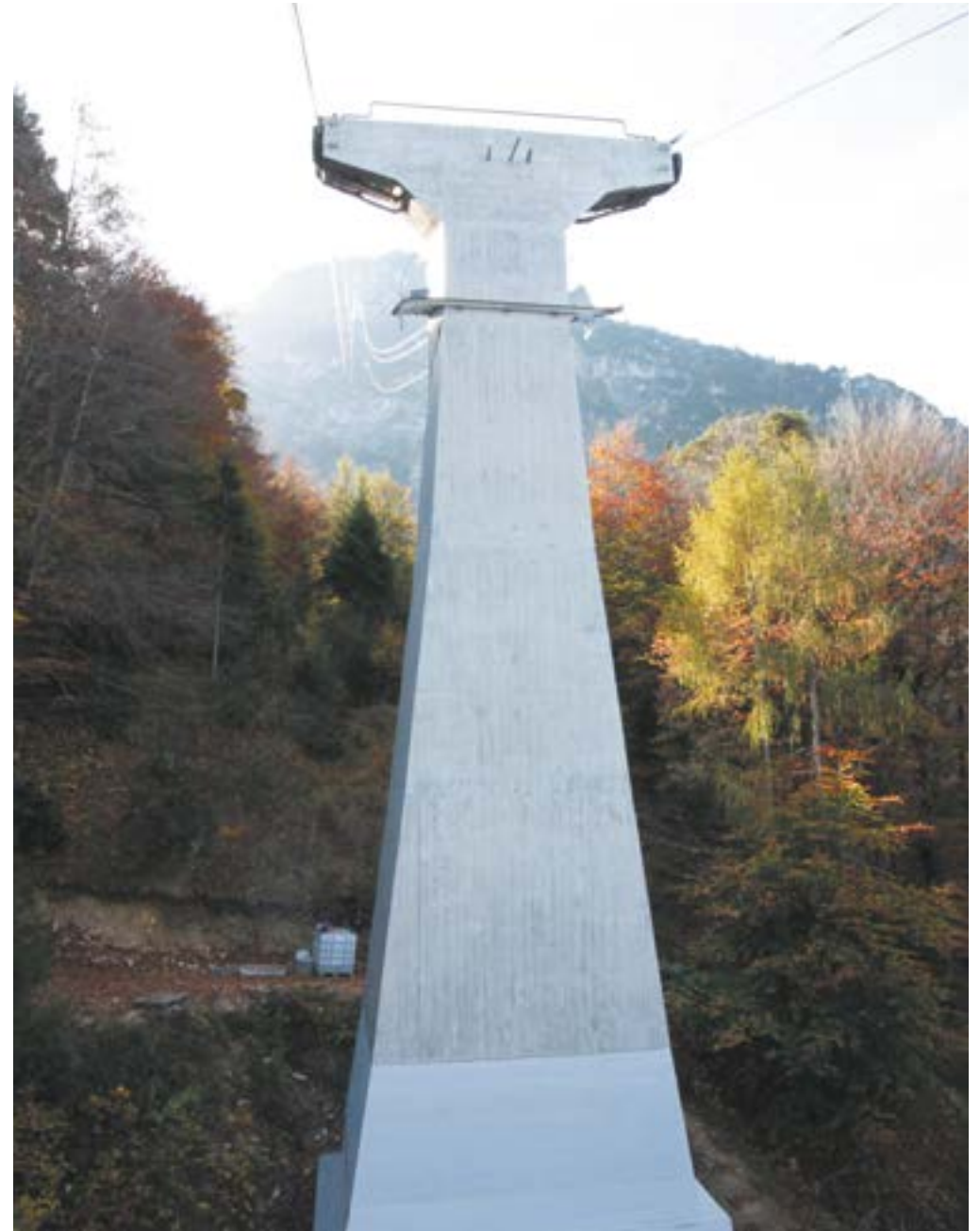
Stütze 1 nach Sanierung mit bauzeitlicher Schalbrettstruktur und transparenter Beschichtung im oberen Bereich und OS 5 Beschichtung im Sockelbereich (mehrere Monate im Schnee)
