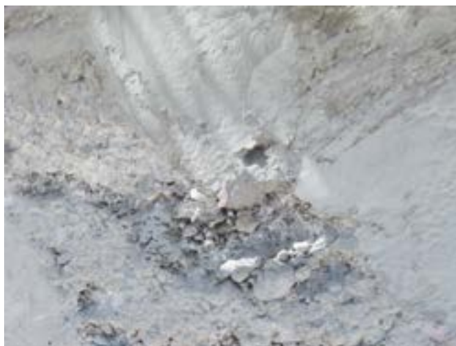
Fehlstellen im Betongefüge
